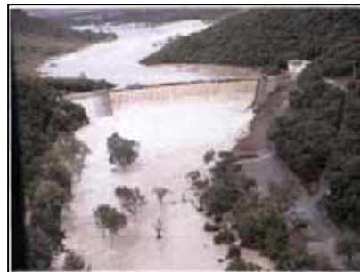
Barrage écrêteur de crue de la Rouvière lors de la crue du 9 septembre 2002, supérieure à sa crue de projet de sûreté. Source : AIGREF n°19
