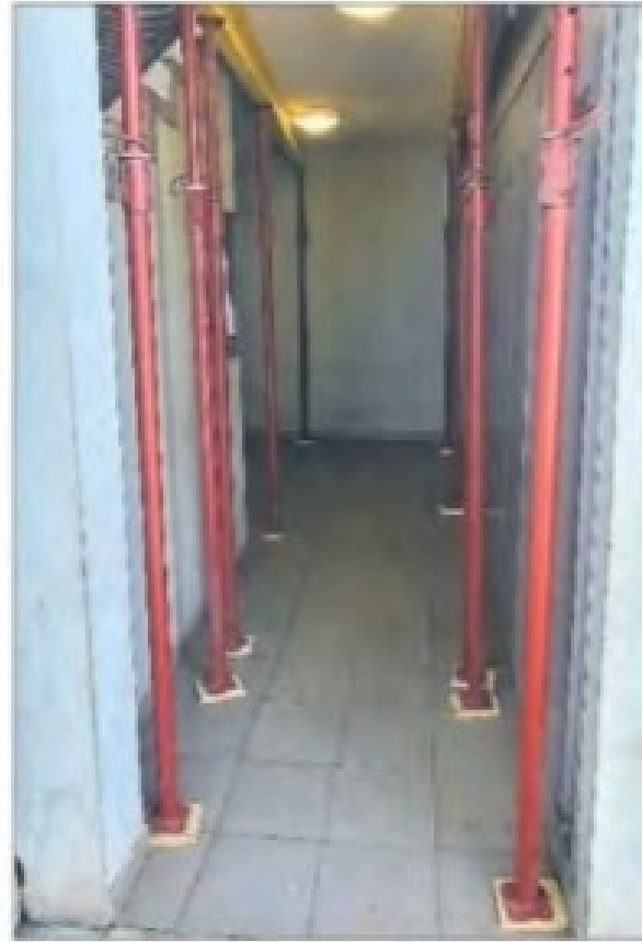
Immeuble Juliette à Saint-Pierre (source : photographie parue dans Le Quotidien de La Réunion le 20 février 2023, coupure de presse fournie par M. Erick Fontaine)
