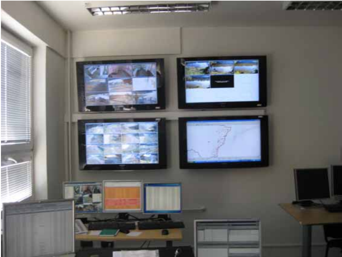
Salle de contrôle centre de Sobrance
